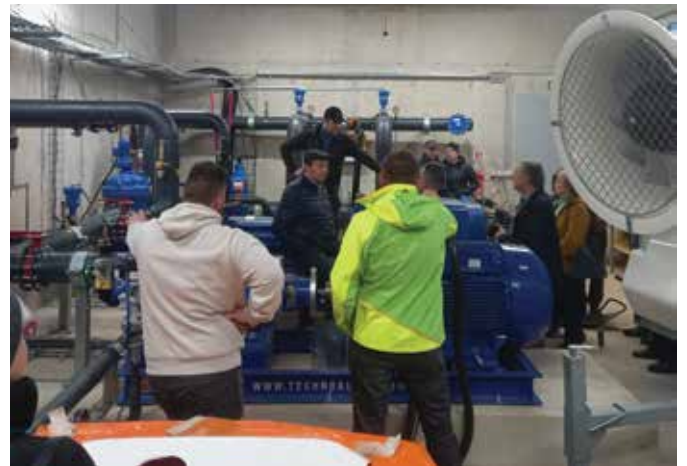
V strojnici za zasneževanje
